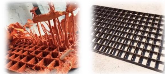
グレーチング剥離
