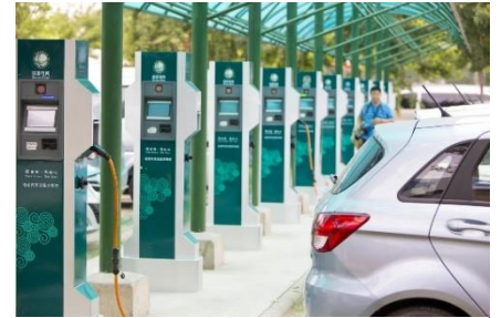
街に広がる充電設備
